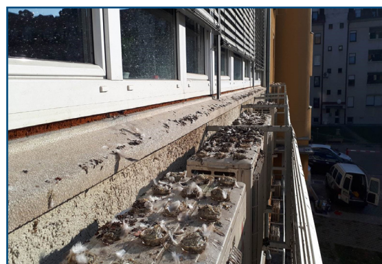
Figura 43. Fire Gel posizionati senza più essere sostituiti o rimossi. (eb)
